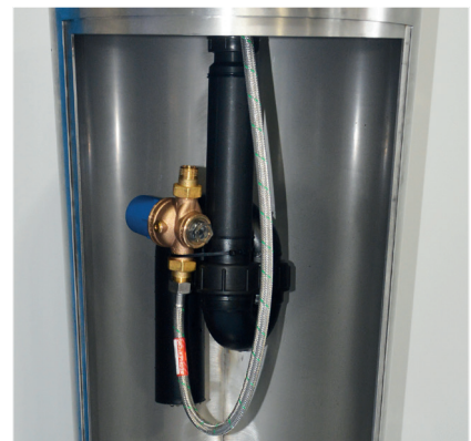
Zu- und Ablauf befinden sich in der Mitte des Trinkbrunnens.
