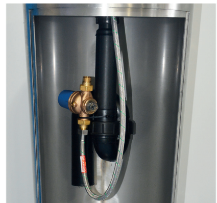
Le système d'arrivée et d'évacuation est situé au centre de la fontaine à eau.
